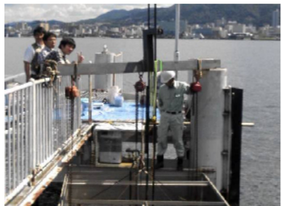
柳崎棧橋に設置している管状酸素ナノバブラー
